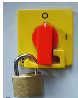
Rys. 43: Wyłącznik główny zabezpieczony
